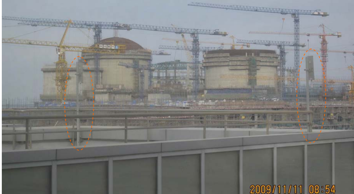
红沿河核电站, 监控中心 6 个 TS14W90 微波网桥组成的中心接收基站
